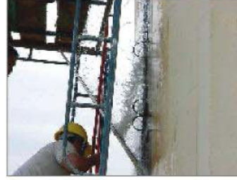
Dilatasyon derzinden aktif şekilde akmakta olan su
