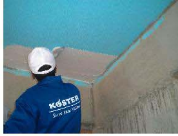
KÖSTER GipsoPLUS kuruduktan sonra oluşan pürüzlü yüzeye alçı sıva çok iyi şekilde yapışacaktır
