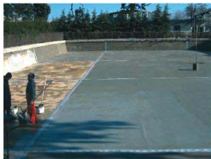
Dilatasyonları KÖSTER Flex Band ile yalıtıldıktan sonra KÖSTER NB Sistem ile su yalıtımı tamamlanan havuz uygulaması
