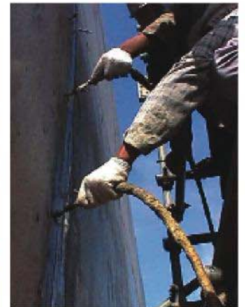
KÖSTER KB Pur 2 IN 1 enjeksiyon reçinesi ile kuru - nemli - ıslak veya statik - dinamik her türlü çatlak enjeksiyonu uygulanabilir
